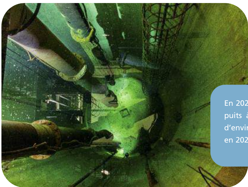
Puits à drains rayonnants
